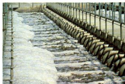
Luftningsbassänger (aktivt slam)
