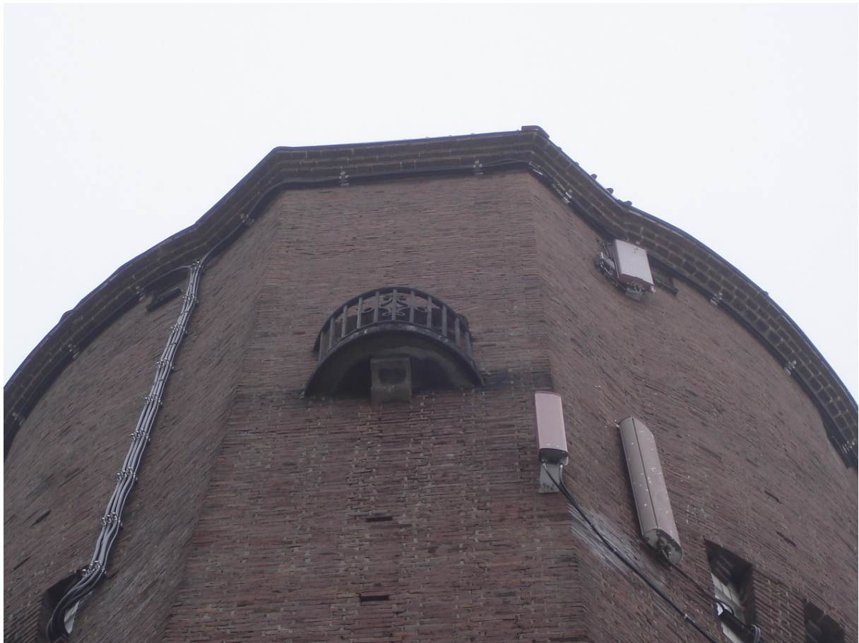
En av fyra balkonger. De är placerade i höjd med cisternen och inte möjliga att nå! Lägg märke till alla elkablar för mobiltelefonmasterna!
