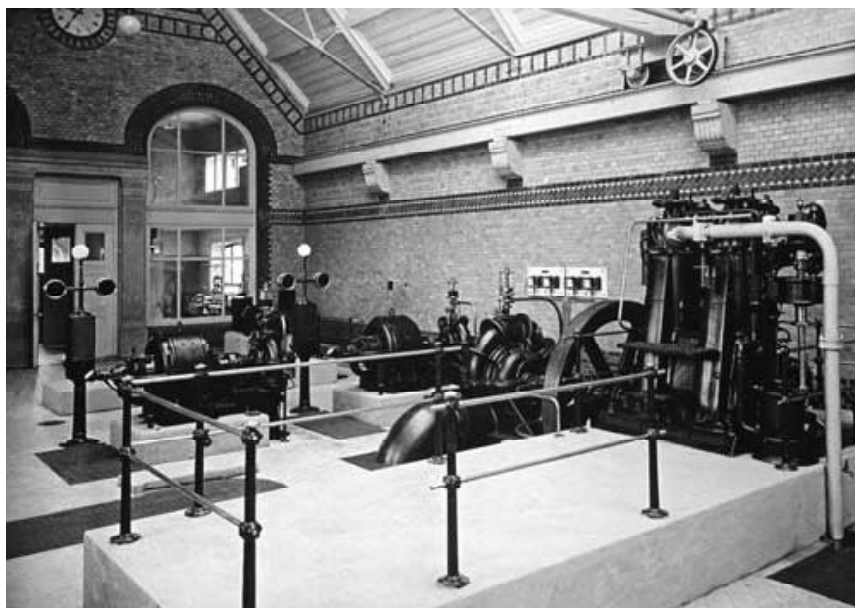
Rosendals avloppspumpstation. Maskinhallen vid tiden för invigningen.
