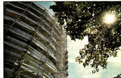
Det funktionalistiska Botildenbergstornet ritades av dåvarande stadsarkitekten Carl-Axel Stoltz. Just nu målas det om.
